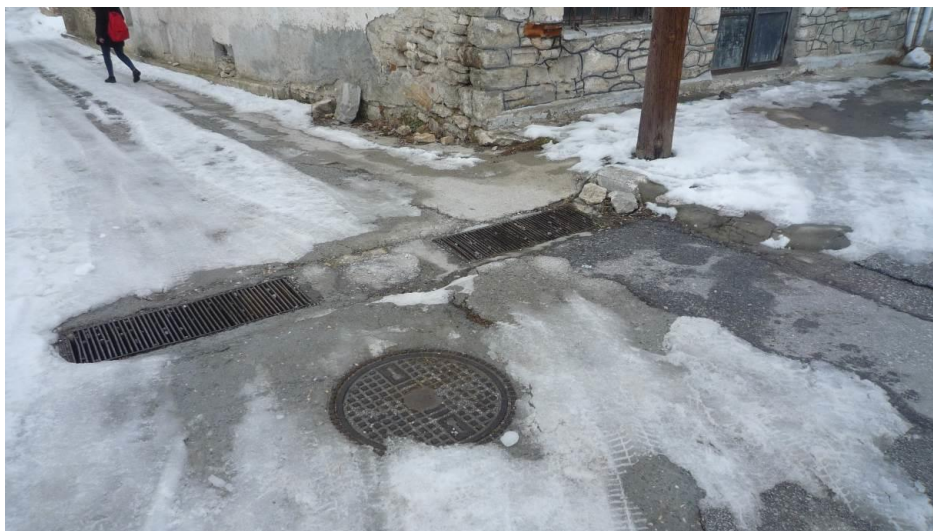
Φωτ. 3.6: Υφιστάμενο φρεάτιο του παντορροϊκού δικτύου με σύνδεση εγκάρσιου φρεατίου υδροσυλλογής, κατάντη της οδού Μεγ. Αλεξάνδρου.
