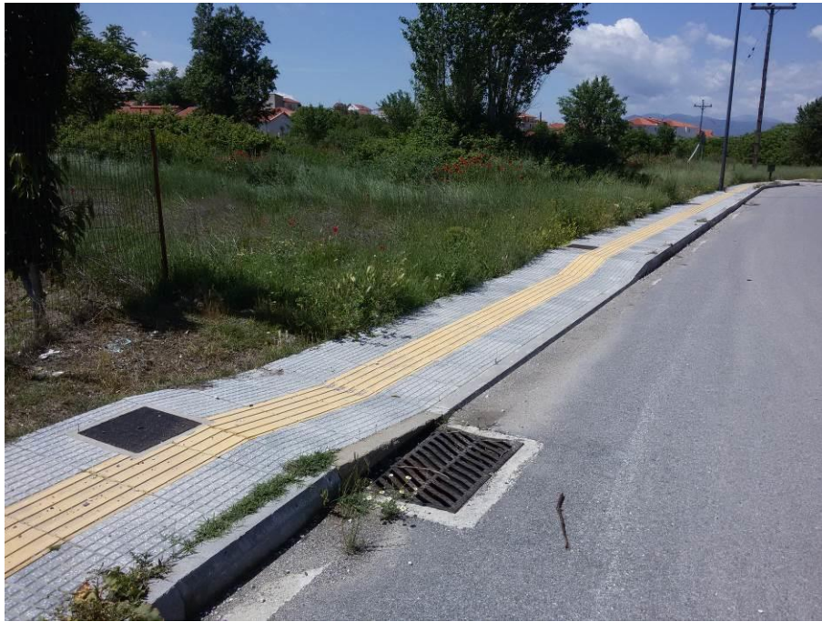
Φωτ. 3.1: Φρεάτιο υδροσυλλογής Βόρειας Περιφερειακής οδού, στην οποία διέρχεται ο υφιστάμενος ορθογωνικός οχετός εσωτερικών διαστάσεων 2x1m.
