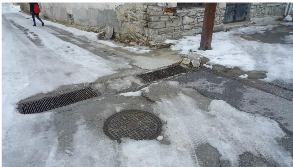
Φωτ. 4.10: Υφιστάμενο φρεάτιο του παντορροϊκού δικτύου με σύνδεση εγκάρσιου φρεατίου υδροσυλλογής, κατάντη της οδού Μεγ. Αλεξάνδρου.
